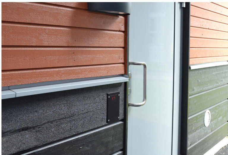
Nexus MO med vandalskjold hænger pænt monteret ved et udendørs skur uden kabeltræk til netværkskabler.
